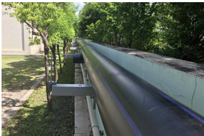
圖六：鳳山溪都汙再生水進水管線 (鄭凌峰攝)
