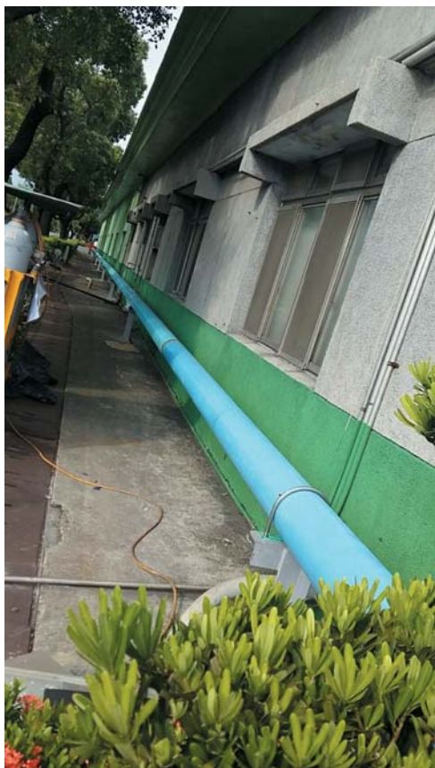
圖八：中鋼廠內新增獨立生活用水管網 (鄭凌峰攝)
